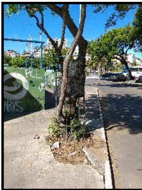
Figura 53: Calçada encurtada e obstruída por arborização com raízes expostas na área de livre circulação e acesso ao anfiteatro da Praça João Mangabeira.
