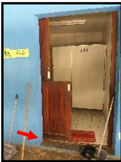
Figura 77: Sanitário “adaptado” com batente na entrada no Parque São Bartolomeu
