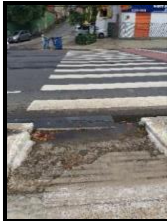
Figura 42: Rampa obstruída por água retida junto à Praça Lorde Cochrane
