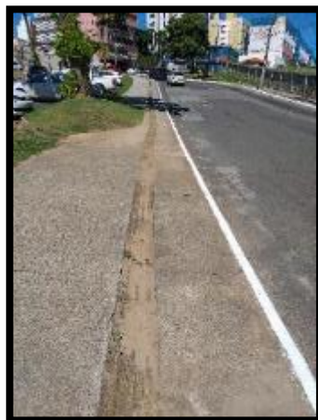
Figura 39: Piso tátil bastante desgastado no entorno da Praça Ana Lúcia Magalhães
