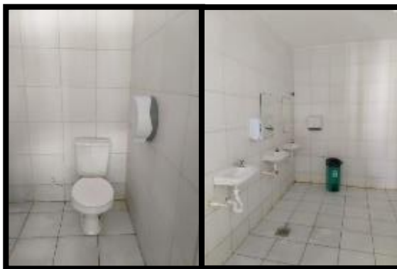
Figura 78: Sanitário “acessível” no Parque são Bartolomeu
