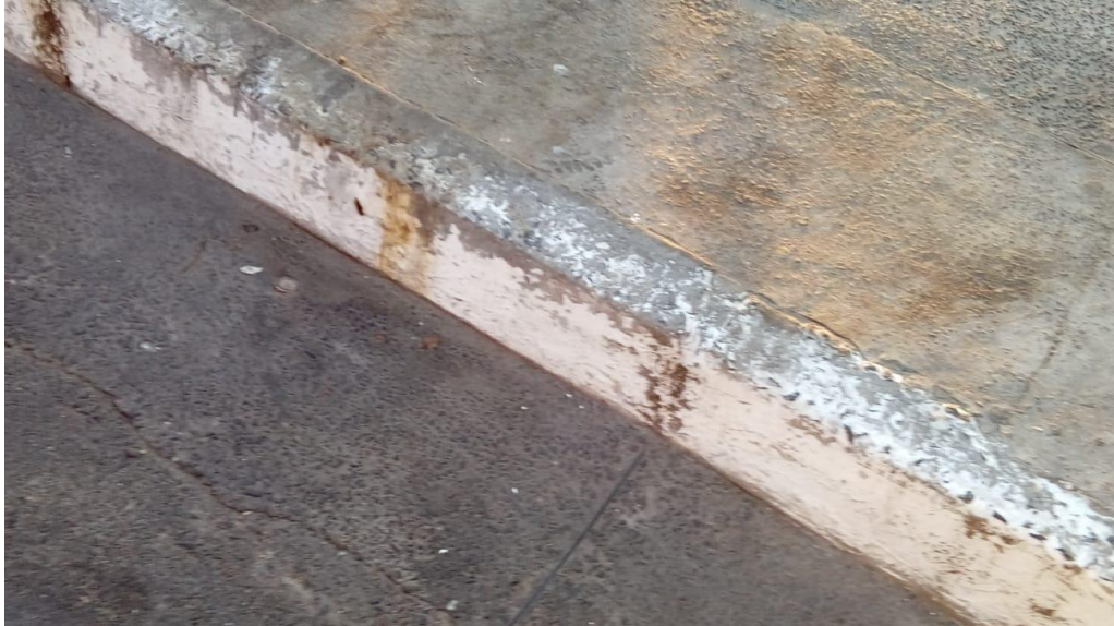
Figura 18 – Fotografia do passeio acompanhado com o Voluntário 2, sendo identificada a ausência de rebaixamento na calçada que dá acesso à praia da Av. Beira Mar, no bairro da Ribeira
