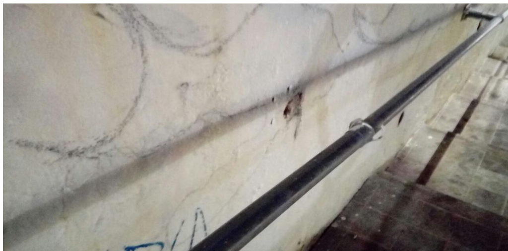
Figura 23 – Fotografia do corrimão quebrado da rampa de acesso de PcD à praia da Barra
