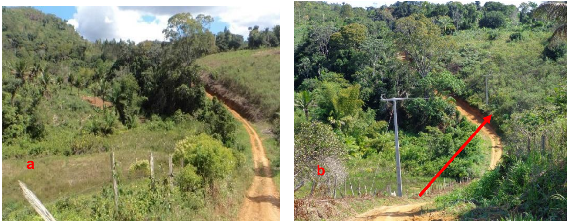
Figura 17: Linha de energia implantada na Comunidade da Fazenda Cantagalo (P6_2), alternando na estrada
