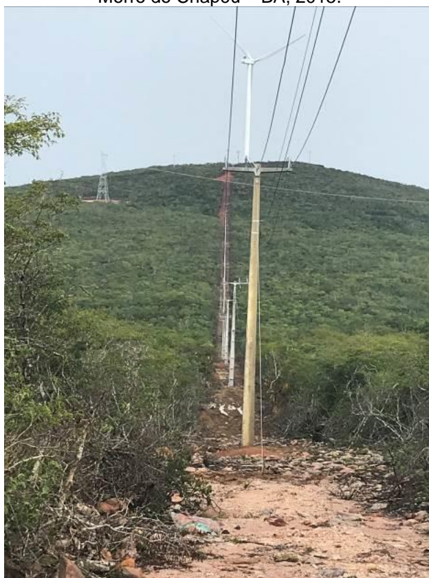
Fotografia 3. Aspecto da rede de distribuição de energia elétrica no complexo eólico Morro Sul, Morro do Chapéu – BA, 2015.
