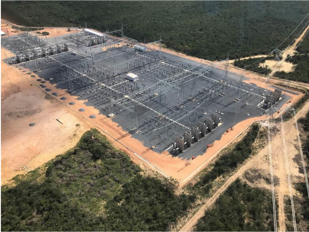
Fotografia 4. Aspecto de uma subestação de energia em complexos eólicos em Gentio do Ouro–BA, 2018.
