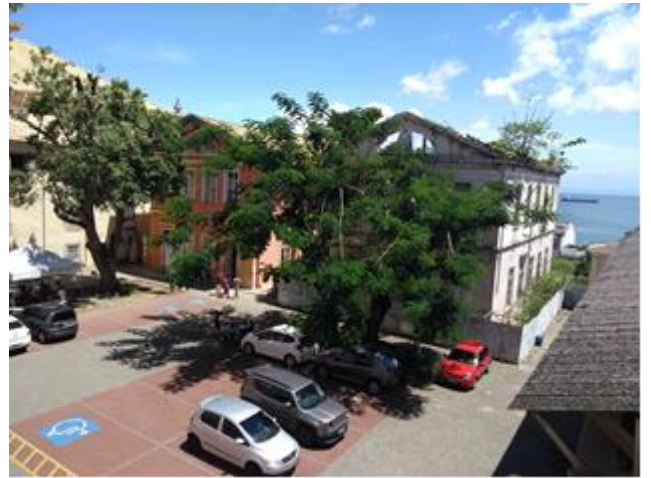
b. Anexo I (esquerda) onde funciona o CAPS e anexo II (direita) em desuso. Nota-se que o anexo II se encontra completamente sem telhado e com barreira de isolamento.
