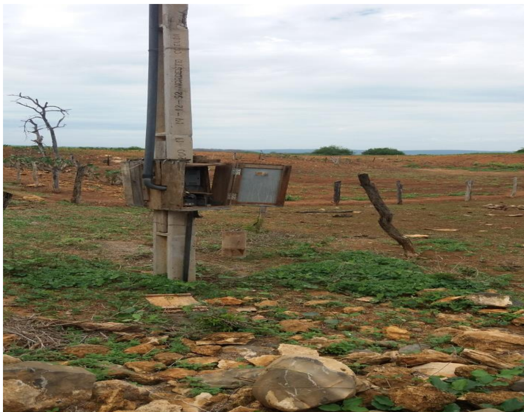
Figura 31 – Poste com armação de caixa de comando de bomba e poço desativado, município de Presidente Dutra-BA, 2017.
