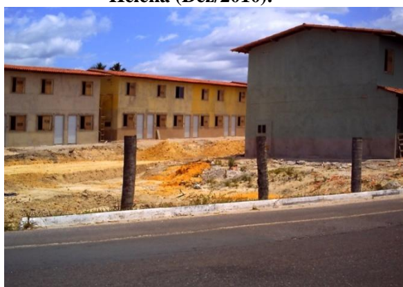
Figura 54 – Construção formal de loteamento residencial, a poucos metros do lago da Barragem de Santa Helena (Dez/2010).
