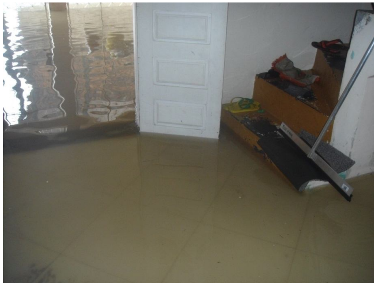
Figura 17 - Casa invadida pela água na rua Monte Sião
