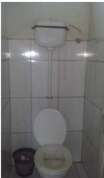
Figura 13 – Vaso sanitário do banheiro
