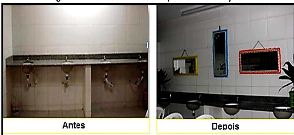
Figura 24 – Lavabo - Antes e depois de intervenções.
