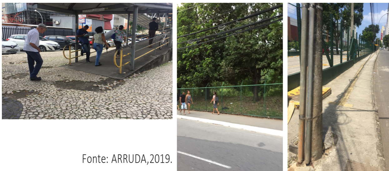
Figura 19: Fotos dos problemas na Infraestrutura Urbana do Entorno Imediato do Terreno.
