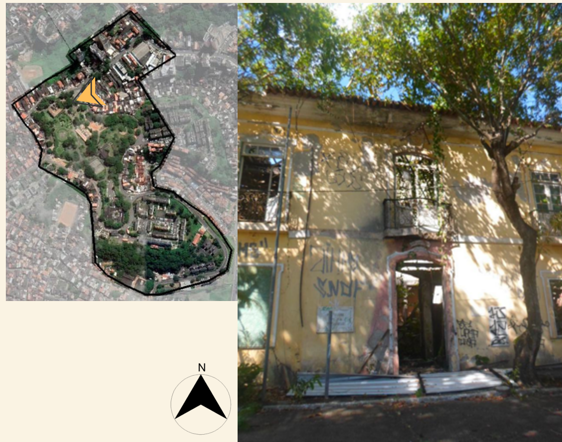
Figura 59: Degradação do casarão
