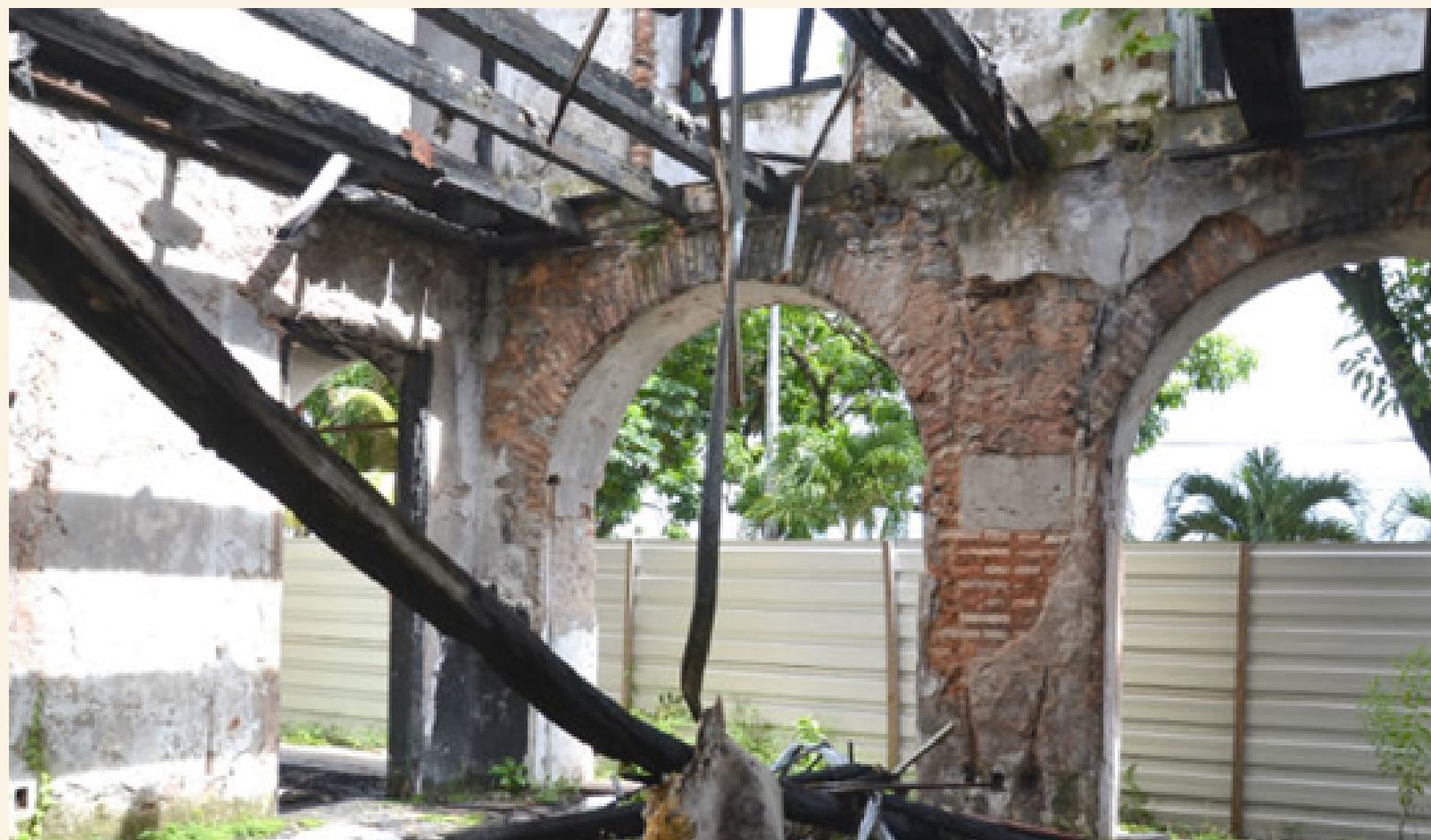
Figura 15: Degradação interna do casarão
