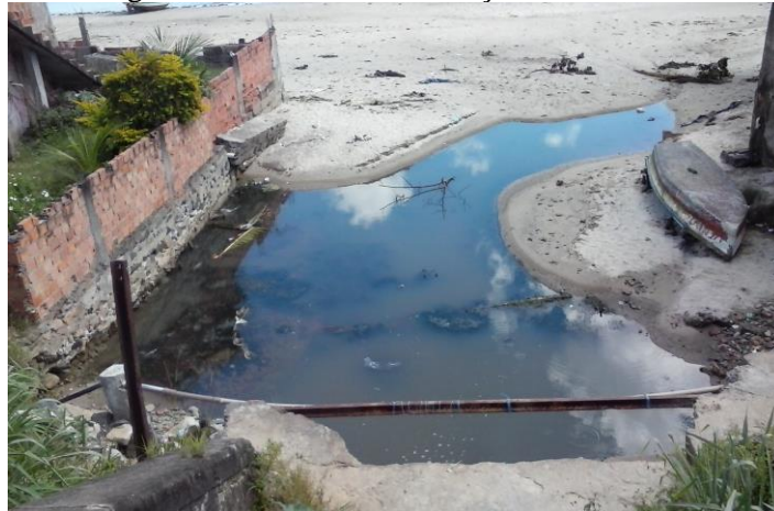
Figura 24 – Esgoto a céu aberto sendo lançado na baía sem tratamento
