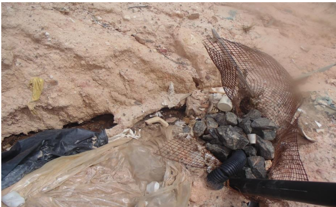
FIGURA 42– Drenos de gás danificados e obstruídos na Célula 3
