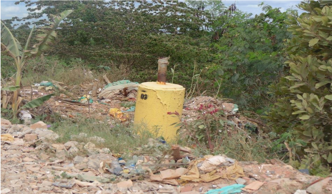
FIGURA 44 – Queimador de gás obstruído e sem chapéu no aterro sanitário, 2015
