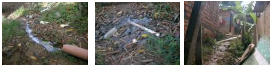
Figura 3 – Esgoto a céu aberto
