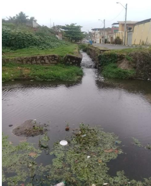
Figura 31 – Canal de drenagem da água pluvial com sobrecarga de efluentes não tratados no Rio Sapato
