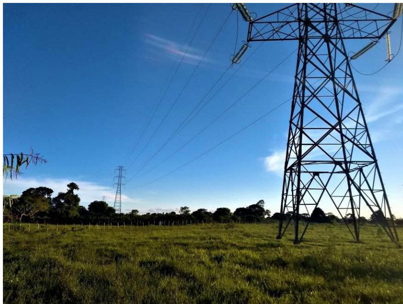
Fig. 05 - Linha de Transmissão
