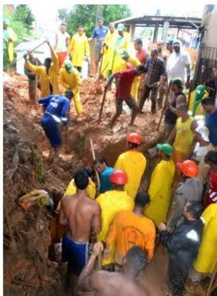
Figura 2 - Imagem de deslizamento de terra no bairro do Bom Juá (2015)
