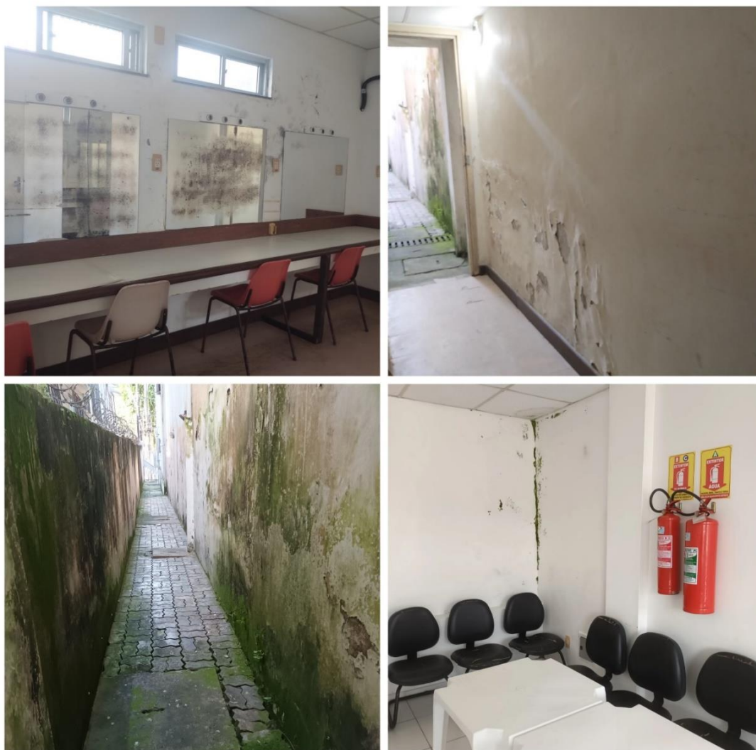
Figura 28 – Registro de problemas estruturais que atingem o CCP
