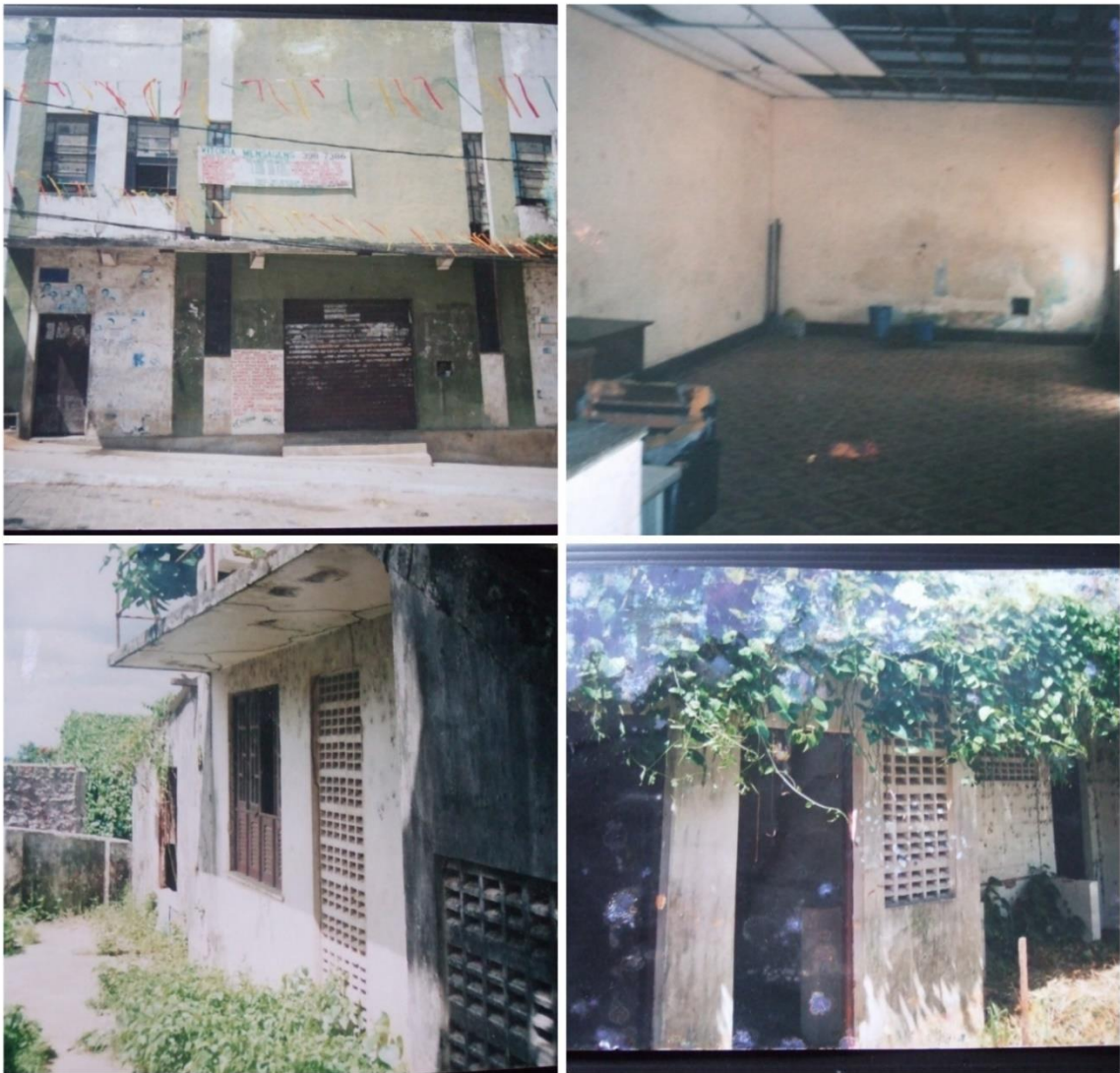
Figura 20 – Fotos da degradação do prédio do Cine-Teatro Plataforma em razão
