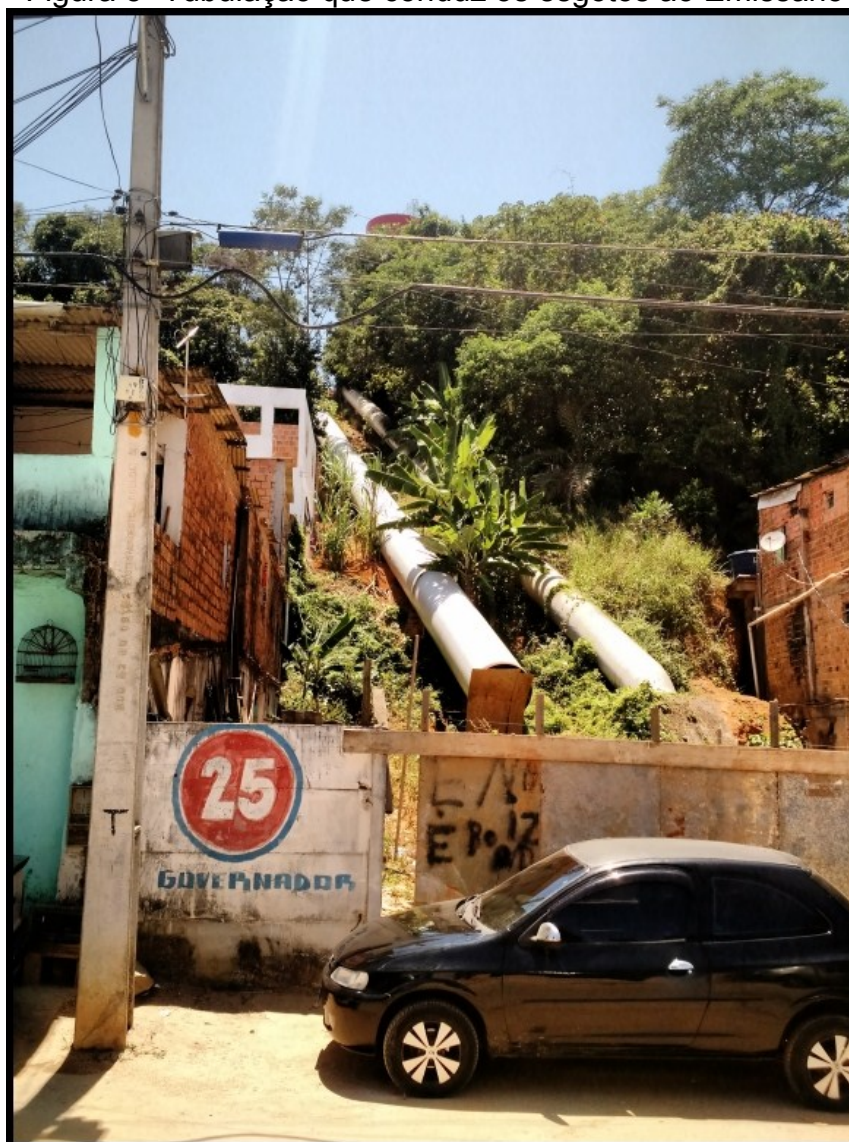
Figura 5- Tubulação que conduz os esgotos ao Emissário
